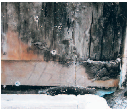
Bild 1: Fukt- och mögelskadad syll och väggregel.
