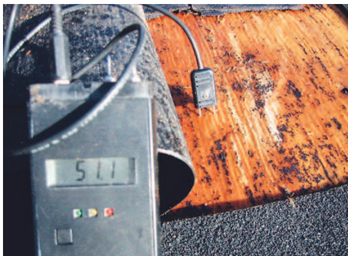
Fuktutfällning mot undersida takpapp på grund av invändigt övertryck i en simhall.
