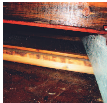
Kondens i takkonstruktion i en simhall.
