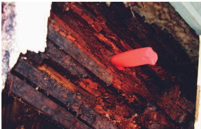
Kraftiga rötskador i en bärande limträbalk i takkonstruktionen i en simhall.
