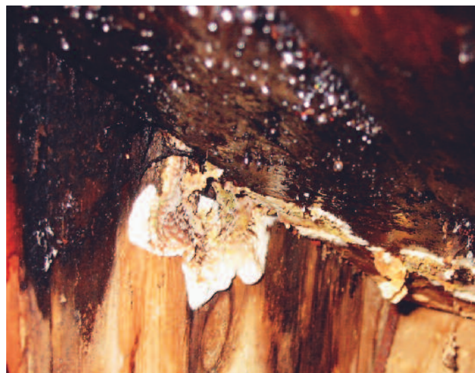
Synlig fukt och rötsvampfruktrop i yttervägg simhall.
