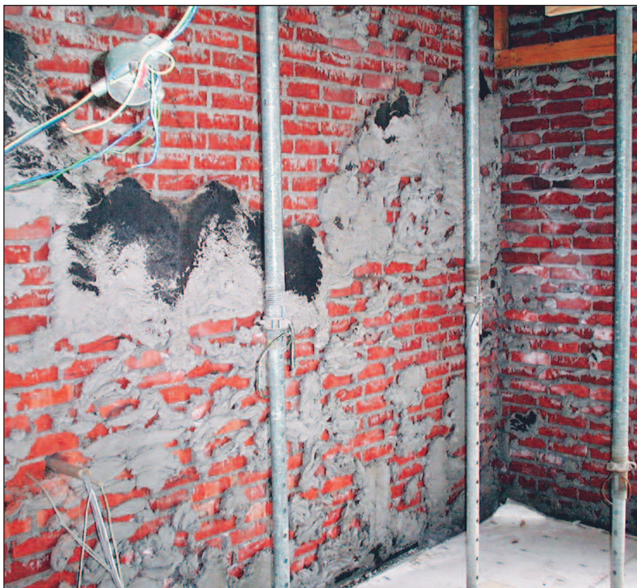
Figur 2: Bruktuggor bakom en tegelfasad.
