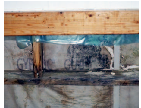
Exempel på fuktskada simhall.
