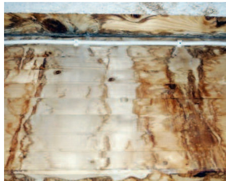
Exempel på fuktskada simhall.
